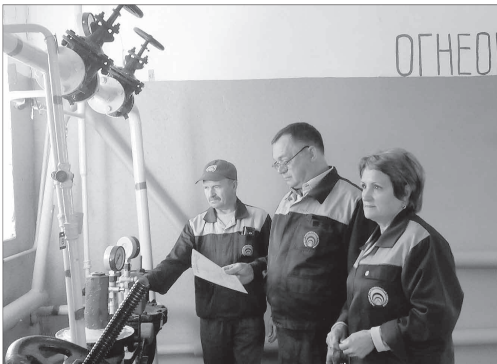
В. Н. Акакин и слесари по ремонту и эксплуатации газового оборудования производят контроль параметров давления.
