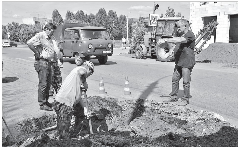
Бригада ООО «Исток» вместе с руководителем Н. Н. Артемовым (на фото справа) работает на очередном объекте.
